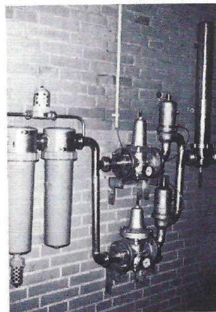
Bild 12 Erzeugung von steriler Förderluft in einem milchverarbeitenden Betrieb
