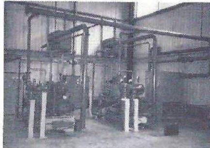
Bild 15 Allgemeine Brauchluft, die bei diesem Maschinenbauunternehmen zentral mit Hilfe von Kältetrockner und Hochleistungs-Ölausscheider aufbereitet wird
